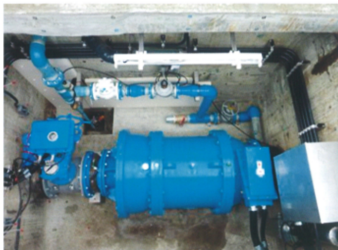
小水力発電設備の一例②
