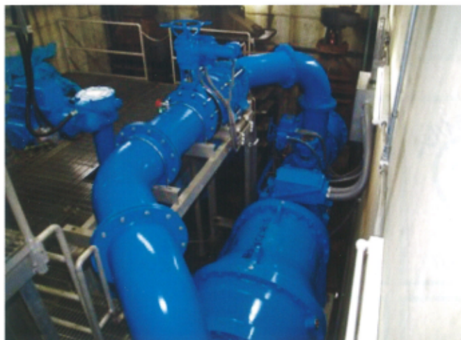
小水力発電設備の一例①
