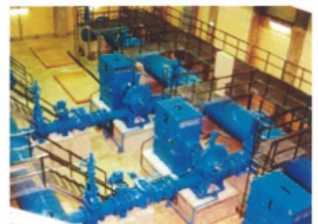
加圧ポンプ所の一例
